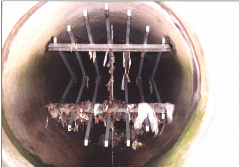
Abb. 3.3: CAPACITY ROD am Entlastungsbauwerk (MW2) der Mischwasserkanalisation
