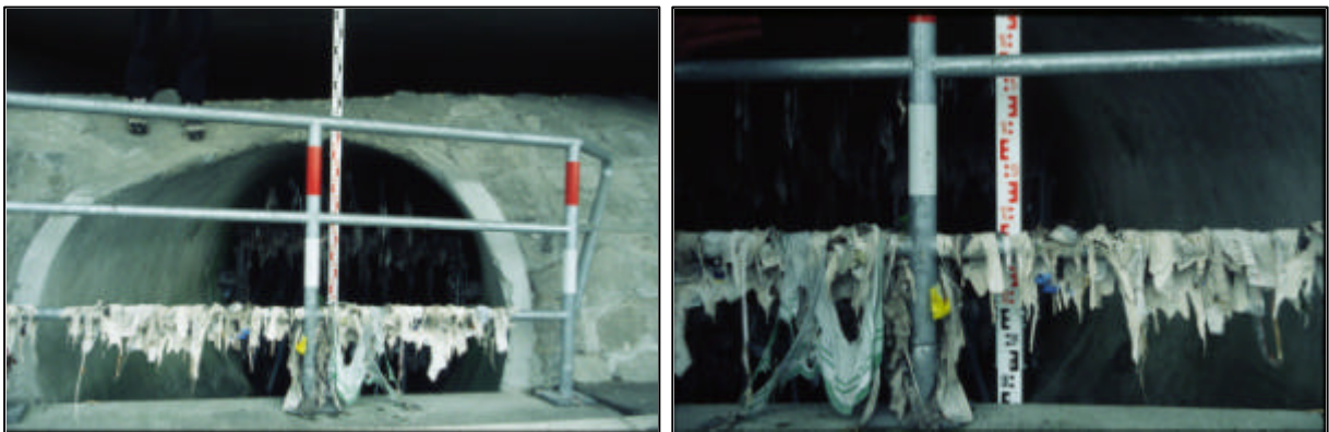
Abb. 4.26 : Entlastungsbauwerk der Mischwasserkanalisation nach dem Entlastungsereignis vom 04.06.02, aufgenommen am 05.06.2002 15 00 Uhr.
