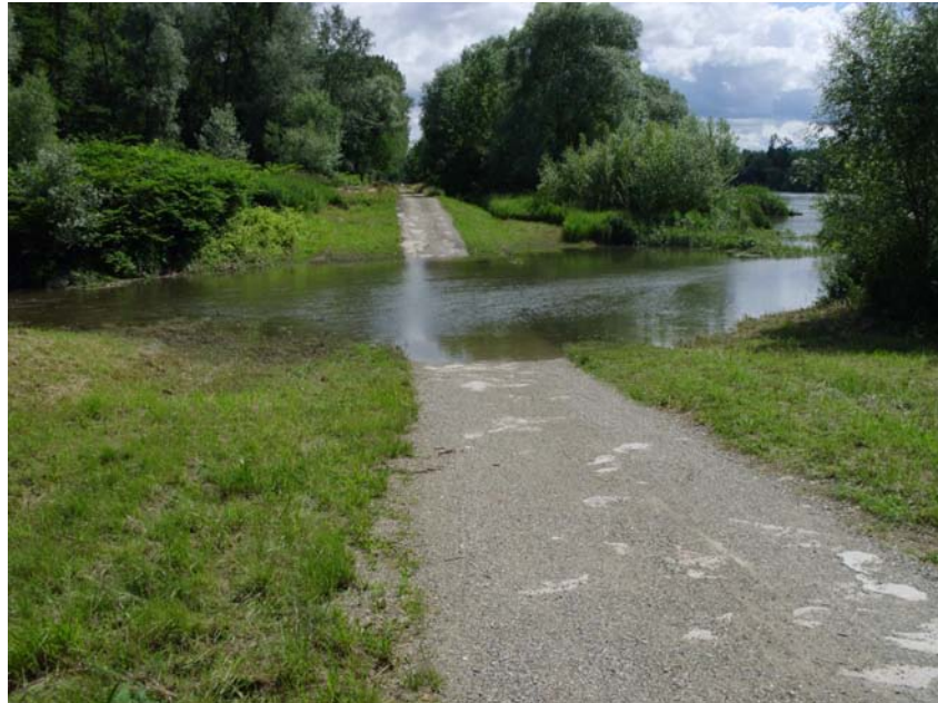
Abbildung 45: Überflutete Bresche (M5) im Tulla'schen Damm in der Nähe des Restrheins (Aufnahme vom 11.06.2012 15:35 Uhr).
